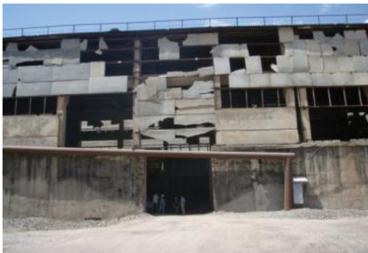
График0-1:Разрушение строения со значительным повреждением асбестовых плит
